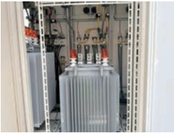
ユーティリティ最適化(変圧器)
